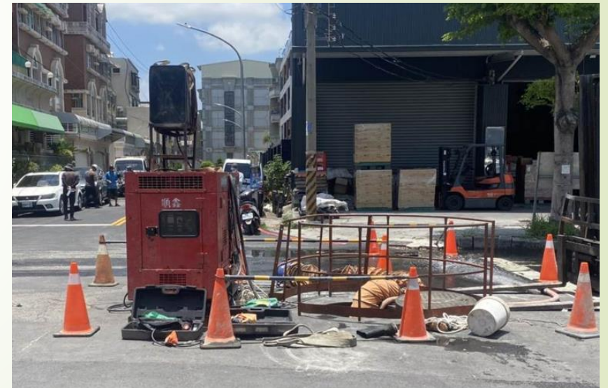
下汙水工程作業沼氣中毒現場
